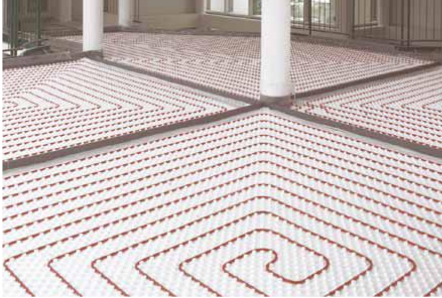
Şekil 8. Yerden ısıtma sisteminin uygulaması [11]
